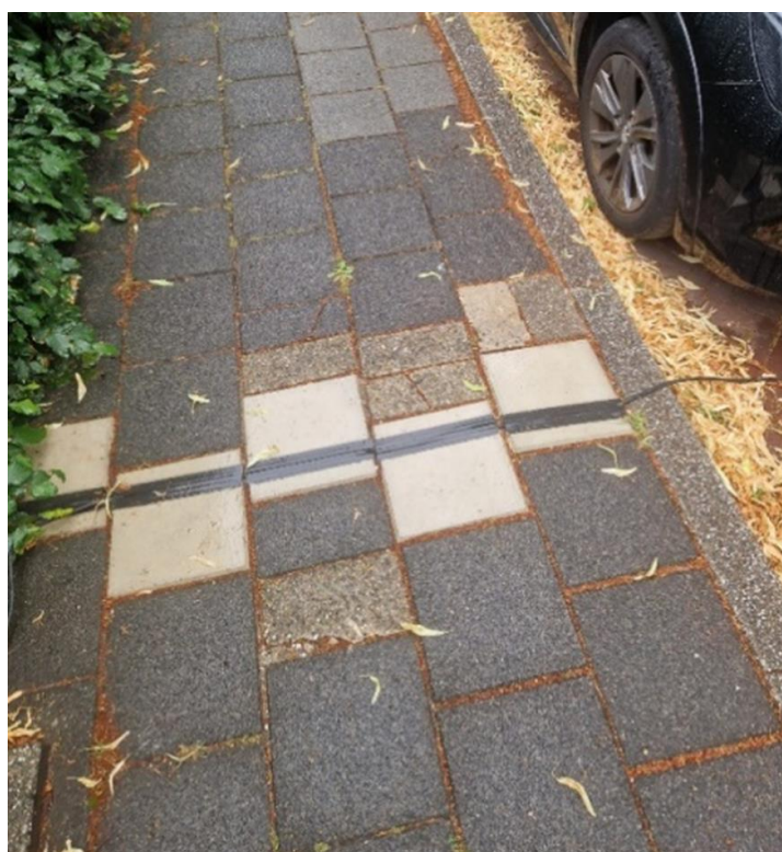
Figuur 24 Kabelgoot (eigen afbeelding)
