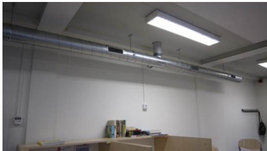
Foto 2: mechanische afvoer in een lokaal in het noodgebouw
