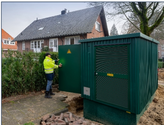
Middenspanningsruimte. Bron: Liander
